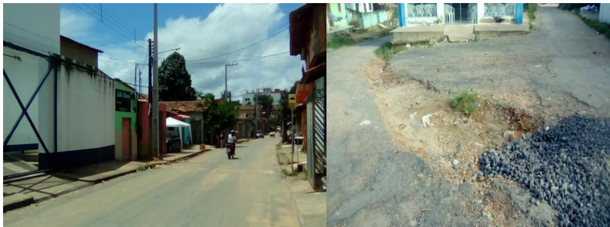
Imagem 14 - Fotos do asfalto e da erosão nas ruas do bairro amapá
